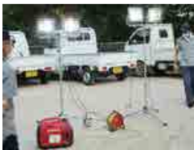
整備された発電機と投光器
